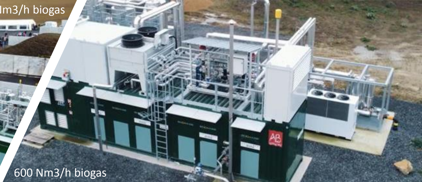
1.200 Nm 3 /h biogas
